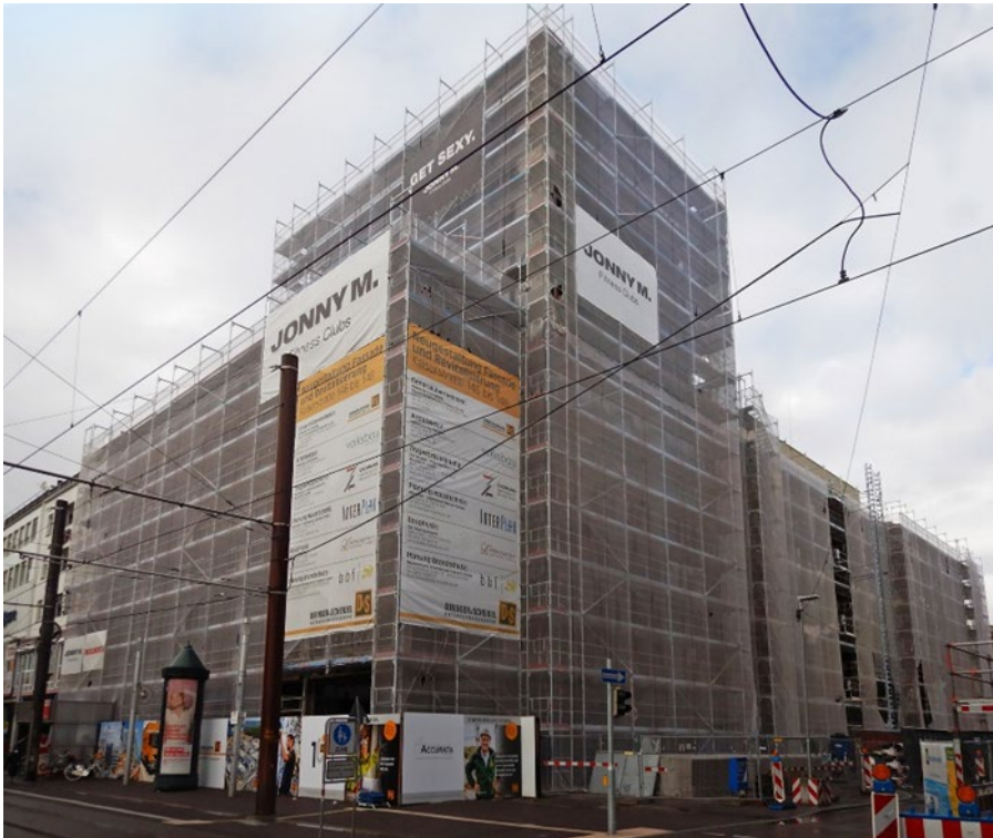
BU: Das Geschäftshaus in der Karlsruher Kaiserstraße 146–148 wird aktuell nachhaltig revitalisiert. Das betrifft auch die Neugestaltung der Fassade. (Bildrechte: volksbau architekten)
