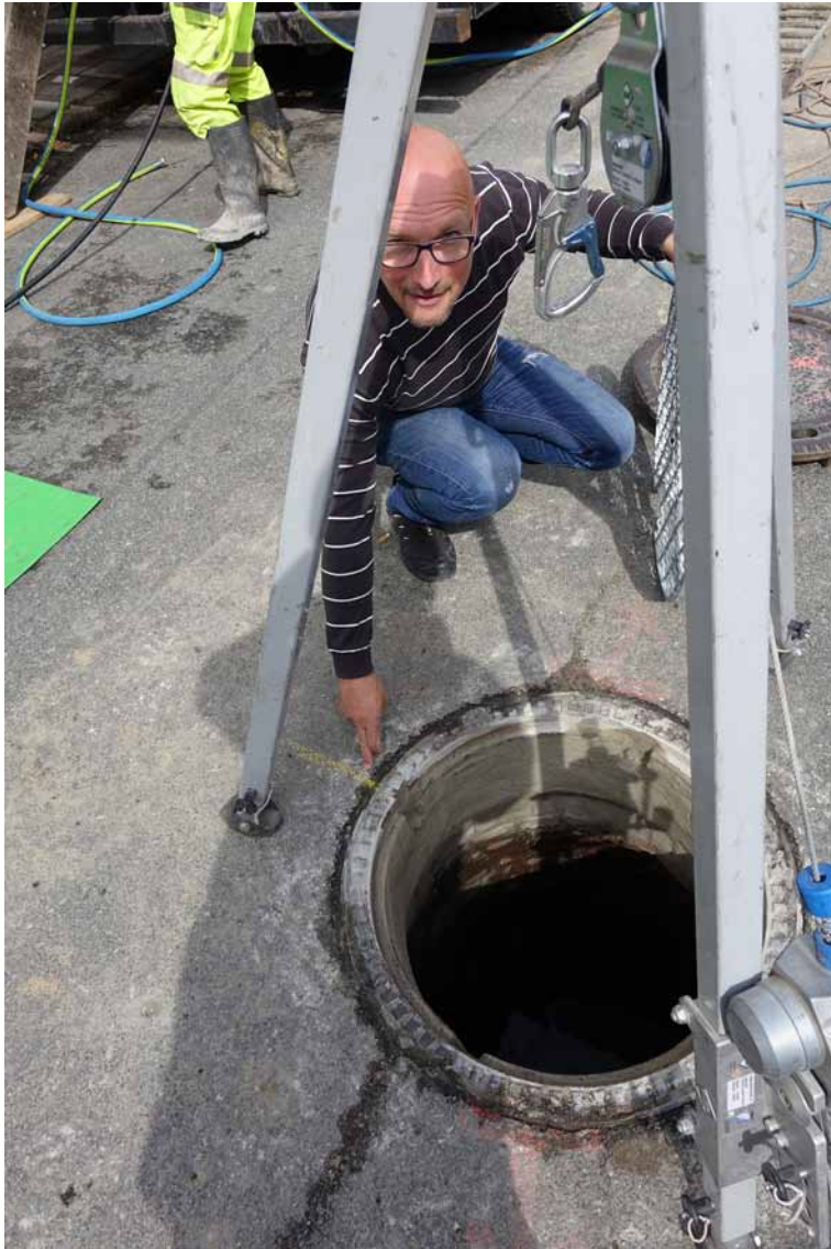
Peter Eschenbrenner zeigt auf die Markierung, die benötigt wird, um den Verteilner® in der richtigen Position in den Schacht einzubauen.
