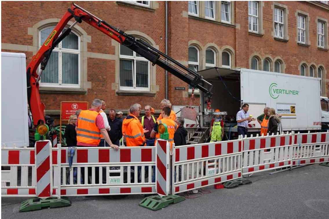
Reges Interesse: Kommunale Auftraggeber und Vertreter von Ingenieurbüros verfolgten den ersten Einbau eines Vertiliners® in Bremerhaven.
