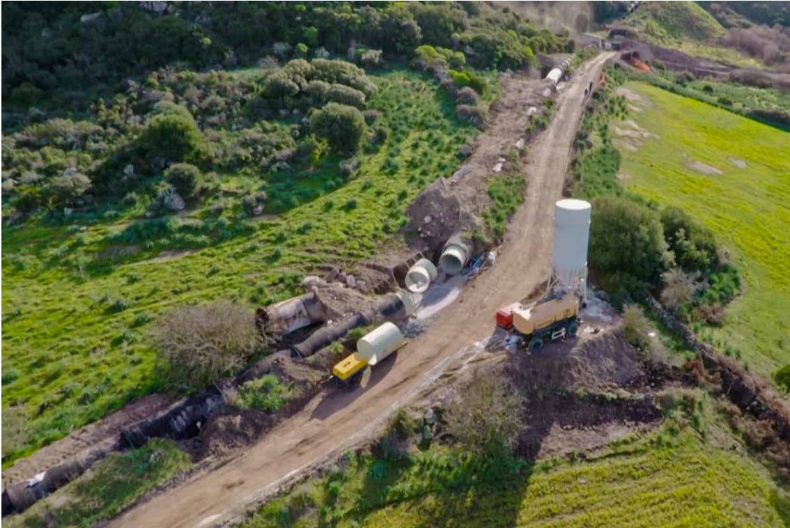
Aus Baugruben in Kurvenbereichen werden die GFK-Rohre in die unterirdischen Abschnitte der Druckrohrleitung eingezogen. Foto: ROTECH
